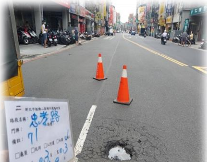
板橋區忠孝路69號到71號坑洞
