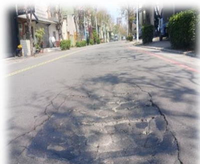
三峽區隆恩街193號坑洞
