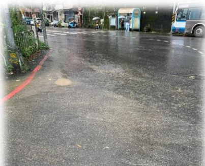
新店區台9跟中生路交叉口坑洞
